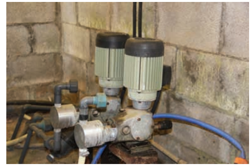
→ Bombas de pistón, para inyección de fertilizantes.
